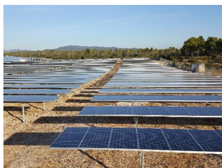
Parc solaire du Castellet II (France)
