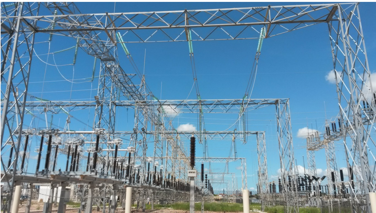
Sous-station du cluster d'Areia Branca
