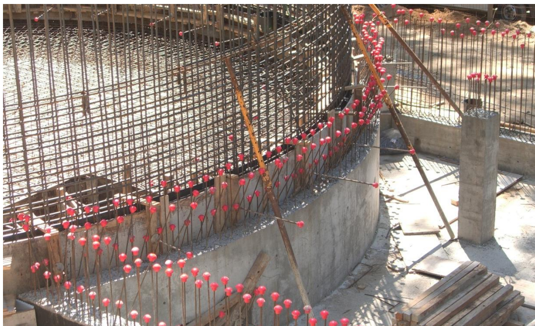
FIGURA 3: AÇO DE REFORÇO SALIENTE COM CAPAS DE PROTEÇÃO DE EXTREMIDADES.
