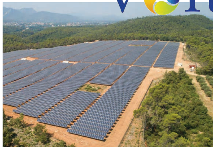
Parc solaire de Canadel - Brignoles - VAR
